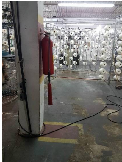
Figura 7 – Chão molhado perto de tomadas de eletricidade
