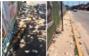
Figura 40 e 41 – Calçada degradada
