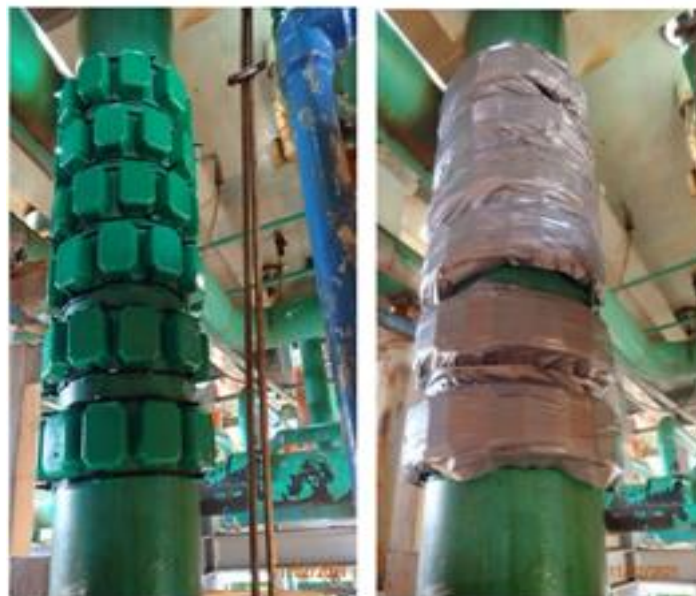
Figura 5. Fotografias de imãs instalados ao redor de tubulação de água a montante dos trens de membranas em unidade de remoção de sulfato
